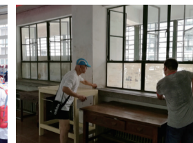
基建处心全意搞建设 查看场馆受损情况
